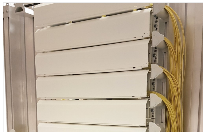
Merkeplater i rack
