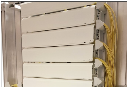
Merkeplater i rack
